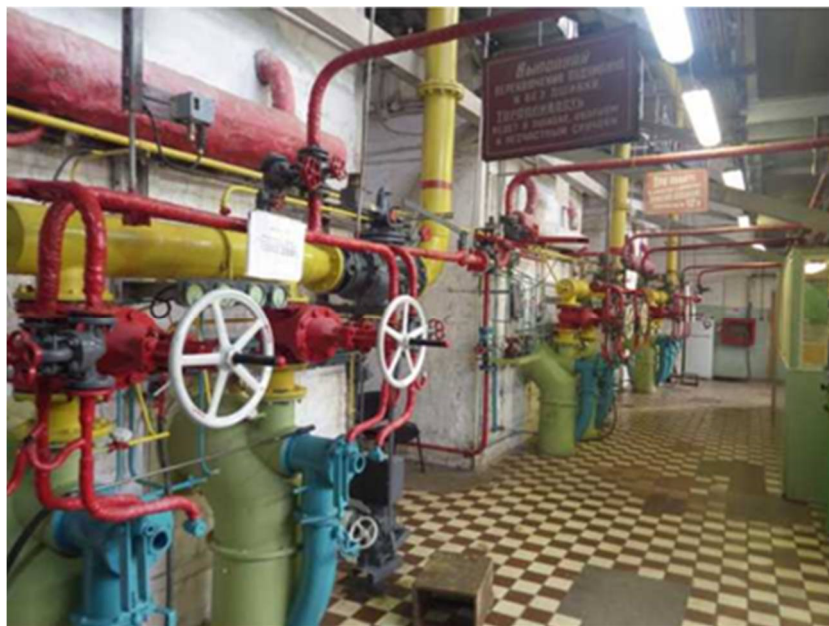
Рисунок 1.9 – Общий вид котельного оборудования котельной №1-а АО «Одинцовская теплосеть»
