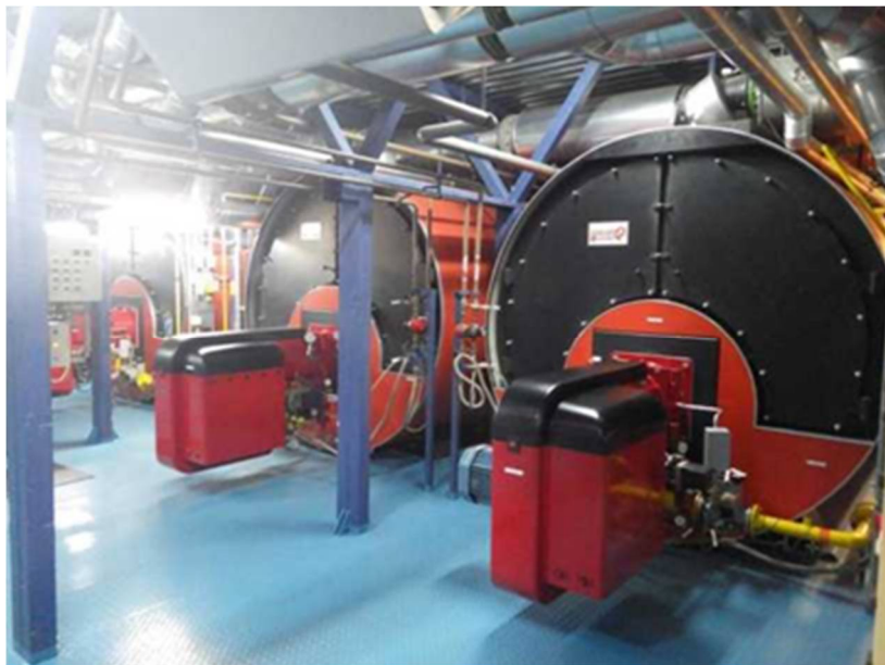
Рисунок 1.40 – Общий вид котлового оборудования котельной «Трехгорка-1» АО «Одинцовская теплосеть»
