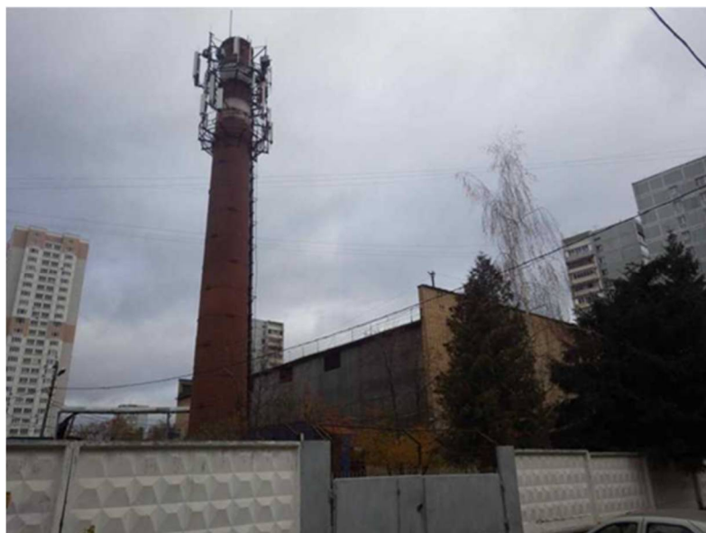
Рисунок 1.16 – Общий вид котельной №8 АО «Одинцовская теплосеть»
