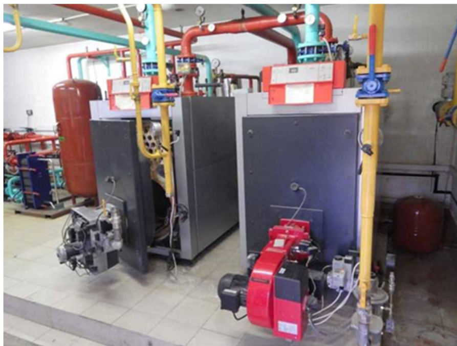
Рисунок 1.29 – Общий вид котлового оборудования котельной п. д/о «Озера» ОАО «РЭП «Немчиновка»
