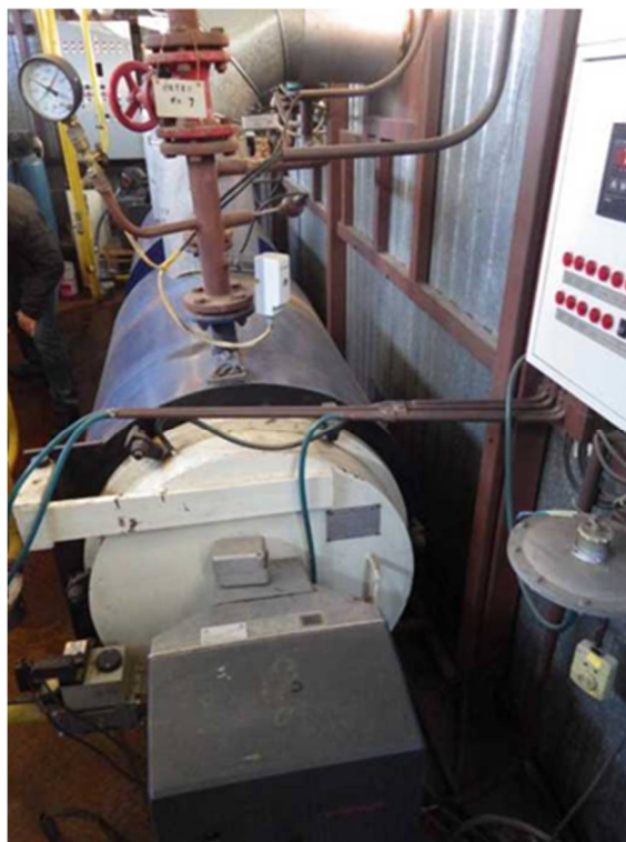
Рисунок 1.31 – Общий вид котлового оборудования котельной с. Ромашково ОАО «РЭП «Немчиновка»
