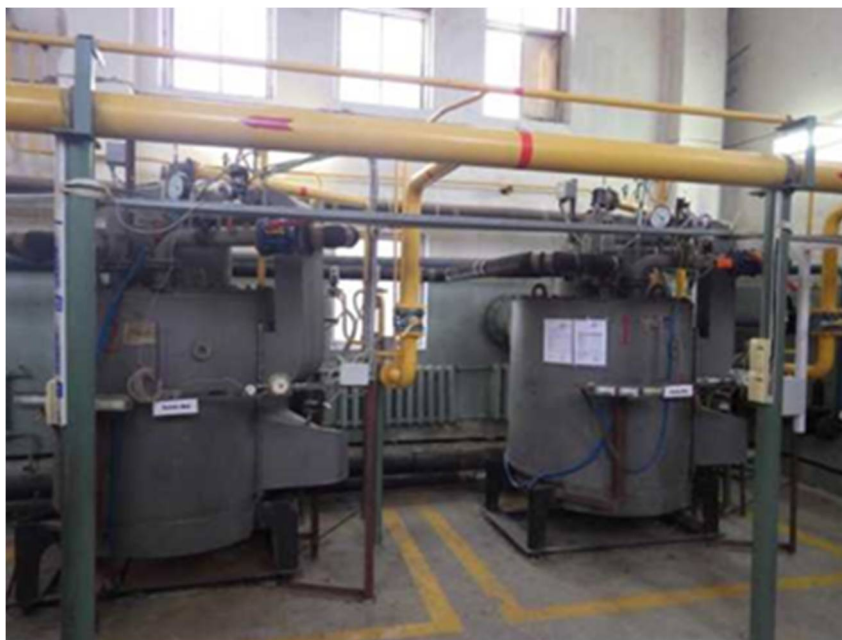
Рисунок 1.37 – Общий вид котельного оборудования котельной №1 ОАО «ВЗОИ»
