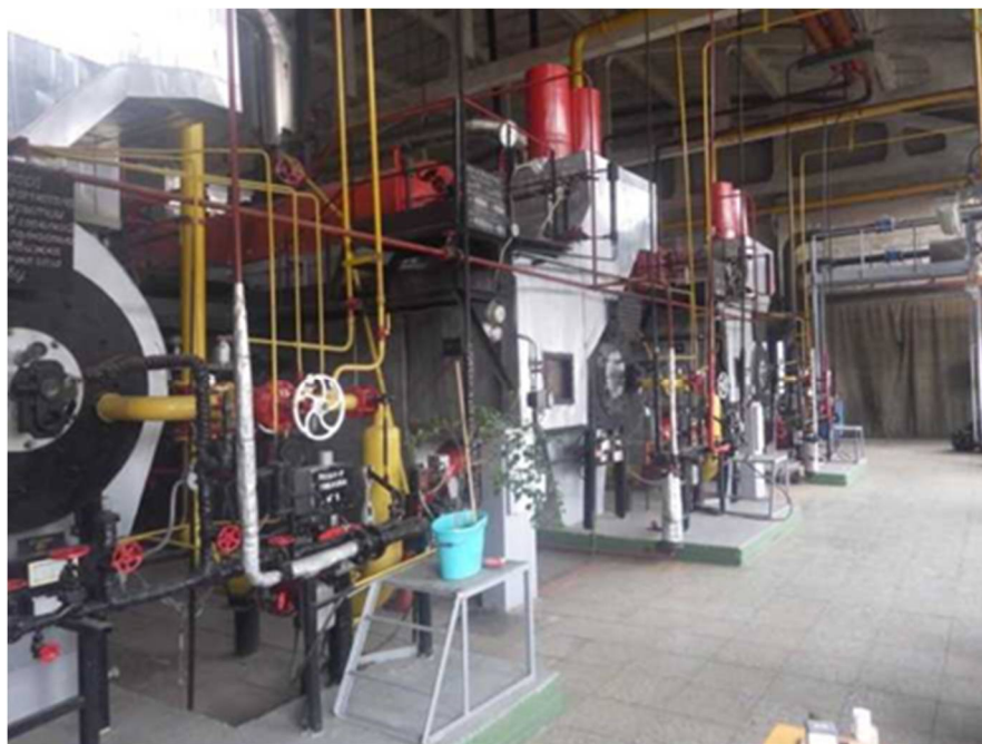
Рисунок 1.35 – Общий вид котельного оборудования котельной ООО «МНЗ»
