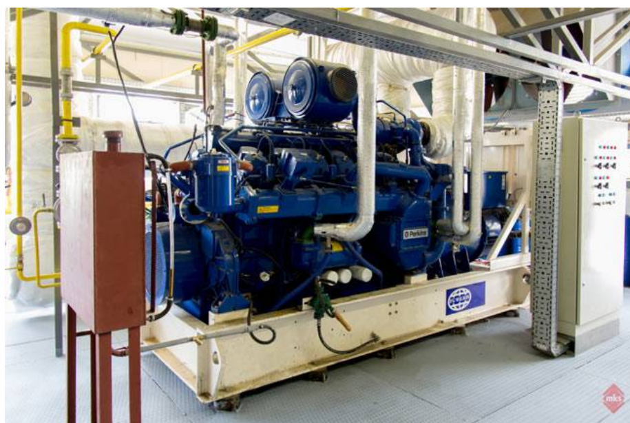
Рисунок 1.50 – Общий вид турбинного цеха мини-ТЭС ООО «УНР-858»
