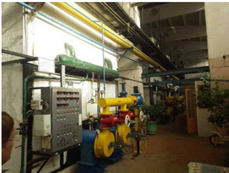
Рисунок 1.11 – Котловое оборудование котельной №3 АО «Одинцовская теплосеть»
