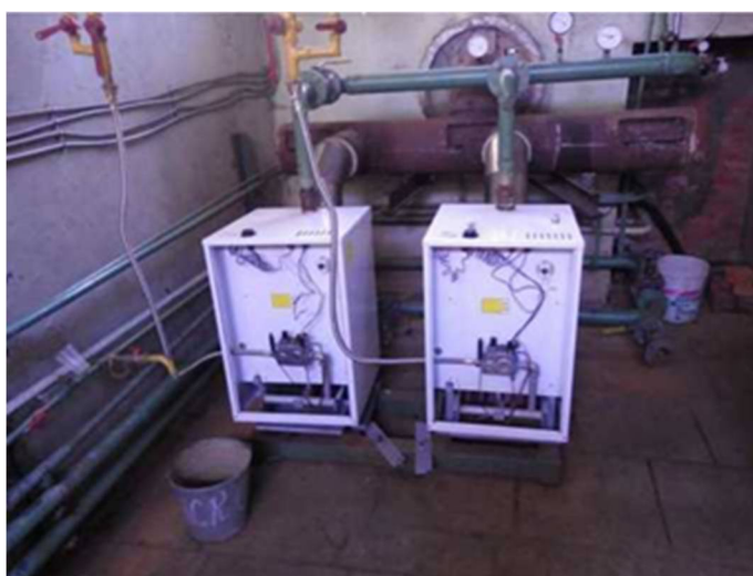
Рисунок 1.33 – Общий вид котлового оборудования котельной с. Немчиновка ОАО «РЭП «Немчиновка»
