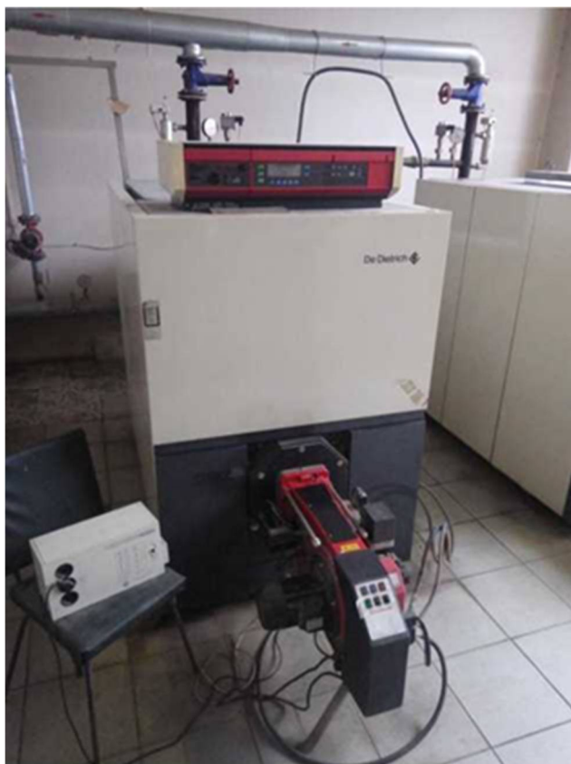
Рисунок 1.27 – Общий вид котельного оборудования котельной базы «Теплосеть» АО «Одинцовская теплосеть»
