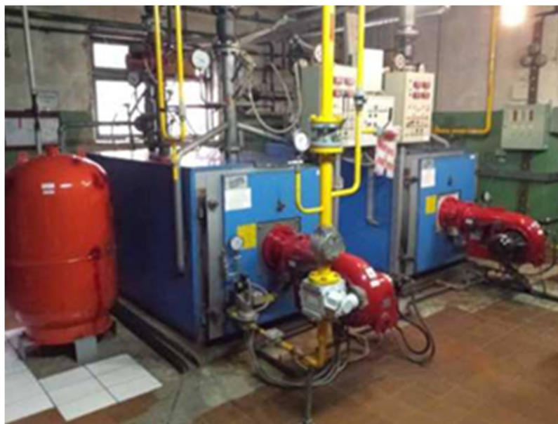
Рисунок 1.22 – Общий вид котельного оборудования котельной «Отрадное» АО «Одинцовская теплосеть»
