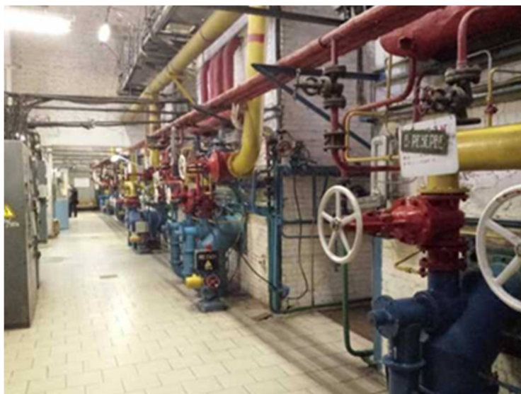
Рисунок 1.7 – Общий вид котельного оборудования котельной №1 АО «Одинцовская теплосеть»
