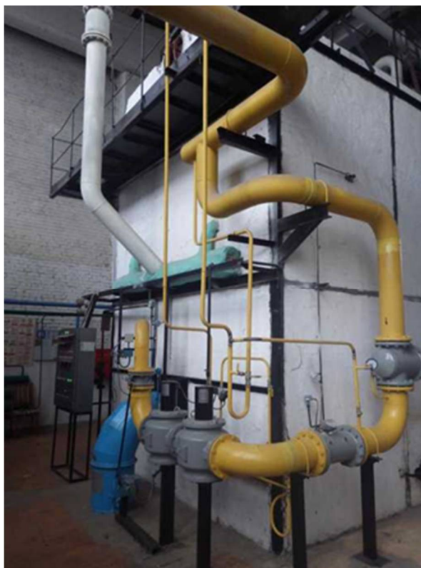
Рисунок 1.10 – Котловое оборудование котельной №2 АО «Одинцовская теплосеть»
