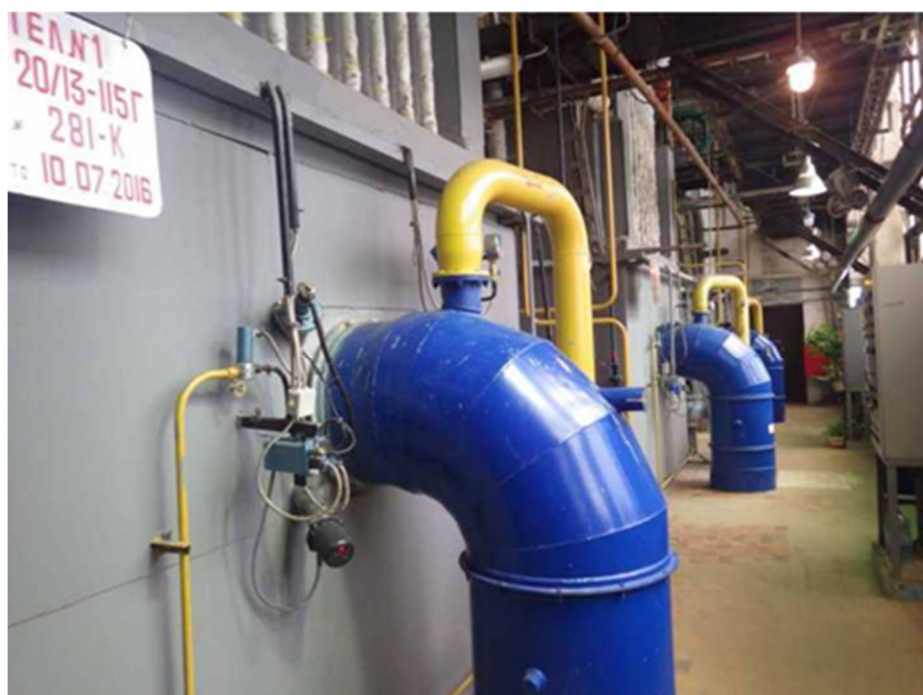
Рисунок 1.15 – Общий вид котлового оборудования котельной №7 АО «Одинцовская теплосеть»
