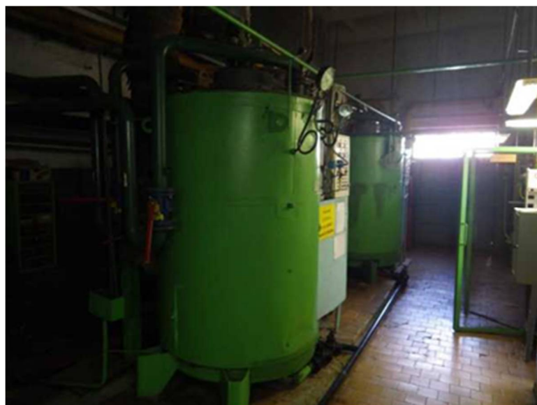
Рисунок 1.24 – Общий вид котельного оборудования котельной Городской бани АО «Одинцовская теплосеть»
