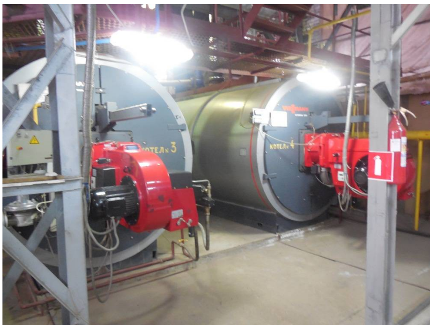
Рисунок 1.44 – Общий вид котлового оборудования котельной ООО «БЗРИ»
