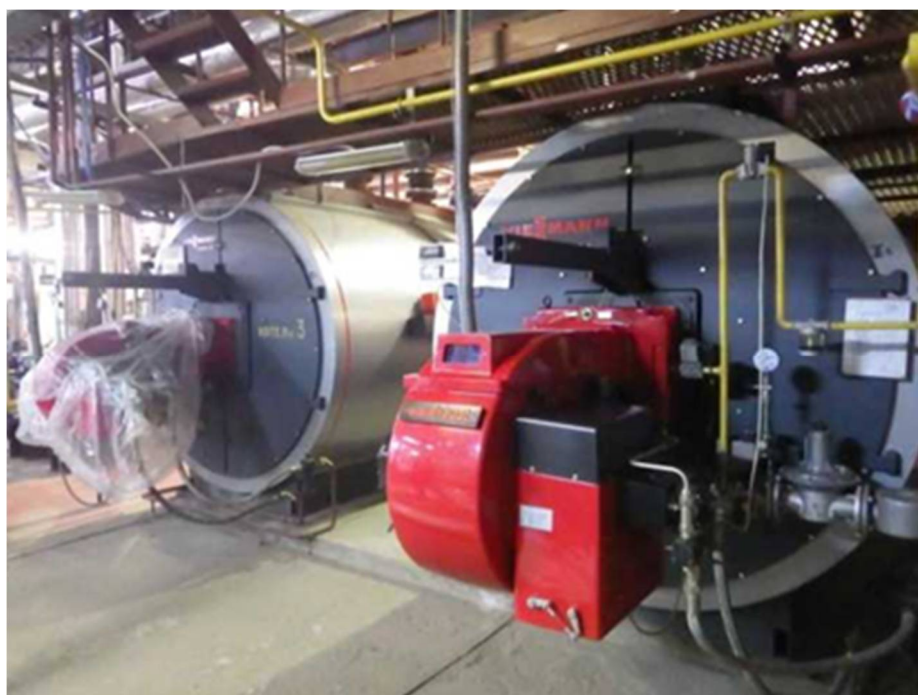
Рисунок 1.47 – Общий вид котельного оборудования котельной №2 ООО «ЖК-Ресурс»
